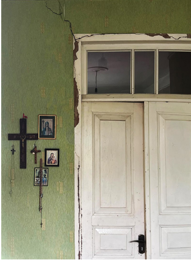
Mine Tunok Sariberberoglu atlak / Crack / Fotoğraf.
